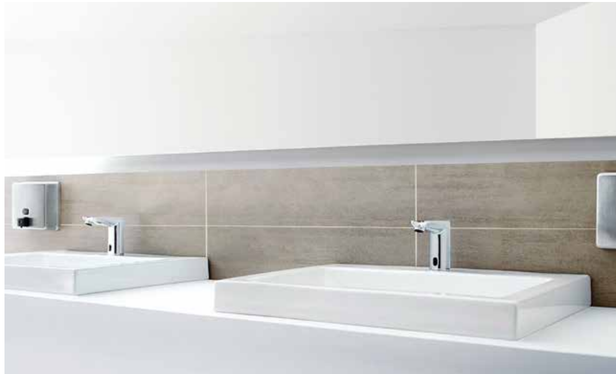
Die Waschtische des Museums sind mit elektronisch gesteuerten Wasserhähnen vom Typ GROHE Euroeco Cosmopolitan E ausgestattet.
